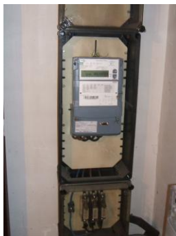
Imatge 2: Comptador d'electricitat (2008)
