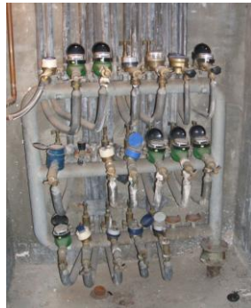
Imatge 30: Bateria de comptadors (2008)
