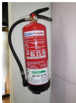
Imatge 41: Extintor pols 21A-113B
