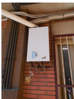
Imatge 26: Caldera a gas
