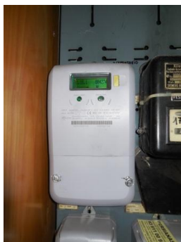
Imatge 3: Comptador electricitat
