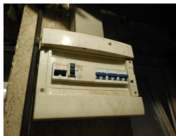
Imatge 6: Quadre climatització
