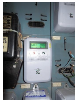
Imatge 4: Comptador electricitat
