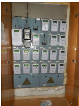
Imatge 2: Centralització de comptador
