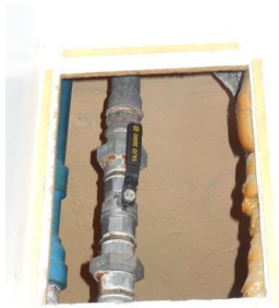
Imatge 17: Clau general entrada aigua
