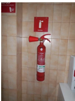
Imatge 22: Extintor de CO 2
