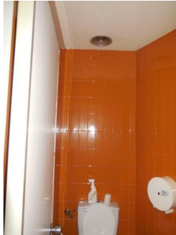
Imatge 16: Reixa ventilació lavabo
