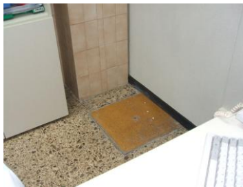
Imatge 29: Arqueta de pluvials
