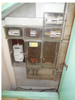
Imatge 2: Centralització comptadors
