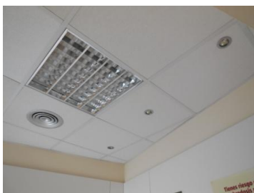
Imatge 6: Enllumenat fluorescent i halogen encasta en cel ras
