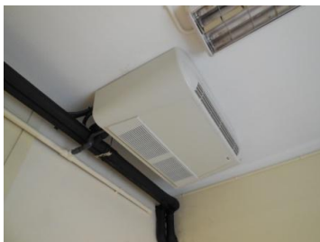
Imatge 12: Fan coil de sostre
