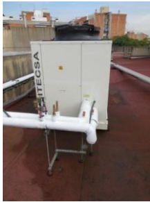
Imatge 10: Planta refredadora – Bomba de calor
