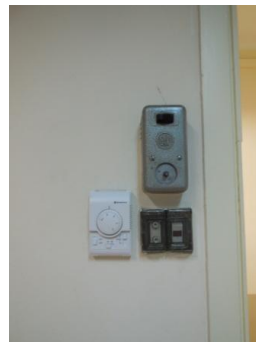
Imatge 17: Control ventilador
