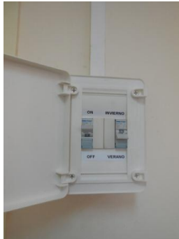
Imatge 15: Quadre control i maniobra climatització
