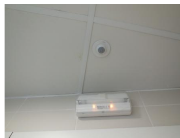
Imatge 8: Detector de presència i enllumenat d'emergència
