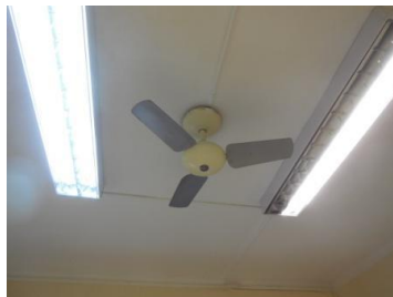
Imatge 16: Ventilador de sostre
